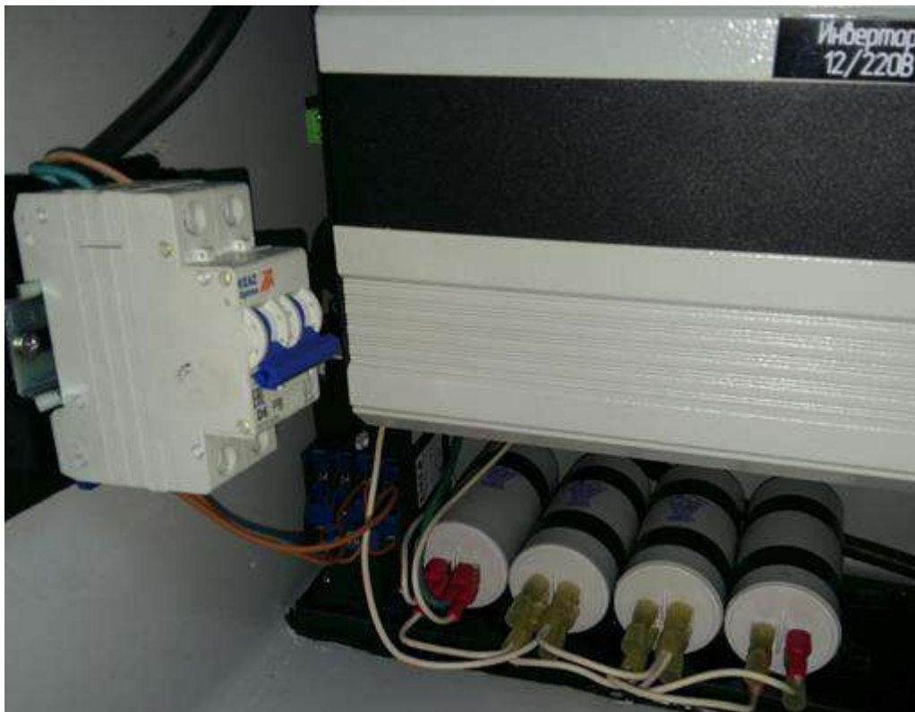
Рис. 2. Смонтированные компоненты UZ, QF, KM, KVT, C1 – C4
