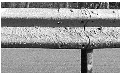
Рис. 1. Состояние ограждений с вертикальной разметкой
