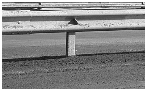
Рис. 2. Места скопления грязевых отложений после очистки элементов
