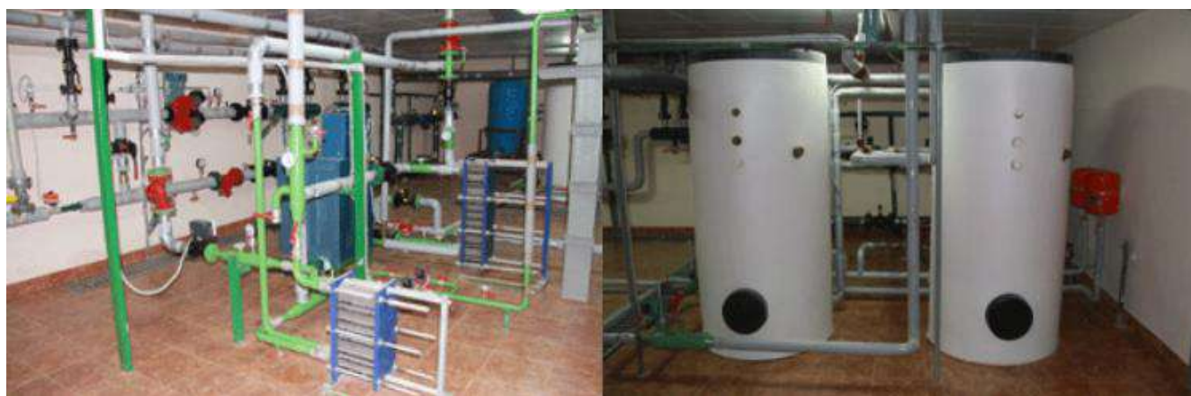
Рис. 3. Внешний вид котельной БГТУ им. В.Г. Шухова
