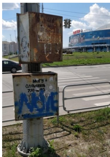
Рисунок 4. Металлические шкафы (КТПС)
